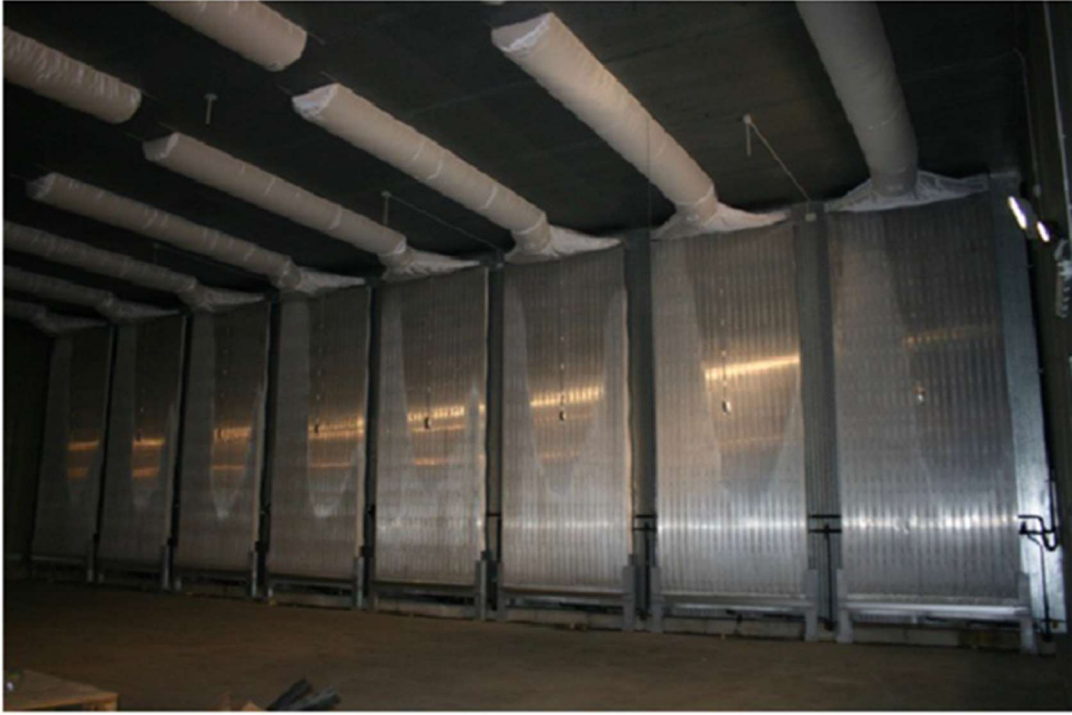
Accumulatori termici montati a parete con ventilazione
